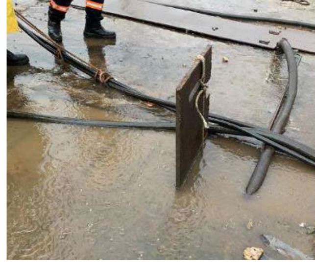
İnceleme sırasında drenaj sisteminin yağmur suyu hacmini taşıyamadığı görülmüştür.
