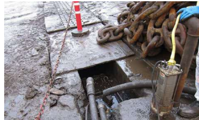
Drenaj sistemi pompası çalışmıyordu.
