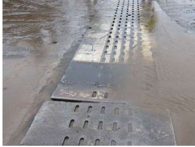
Taşan birincil drenaj hattı
